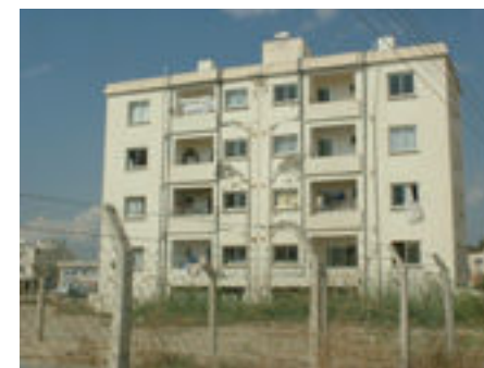
Resim 5. Nem oluşumu ve cephelerdeki hasarlar (Fotoğraflar: Kozan Uzunoğlu, Semra Sema Uzunoğlu arşivinden, 2015).
