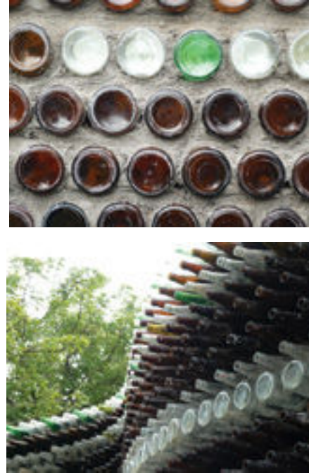
Resim 19-20. Islak hacimlerin duvarlarında cam şişelerden yapı elemanı (Kaynak: Anupama Kundoo, 2011, https://archnet.org/sites/15691 ).
