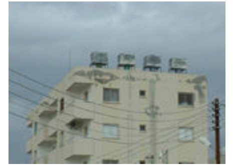
Resim 1. Betonarme ve tuğla örgü parapet birleşiminde oluşan çatlaklar (Fotoğraflar: Kozan Uzunoğlu, Semra Sema Uzunoğlu arşivinden, 2015).
