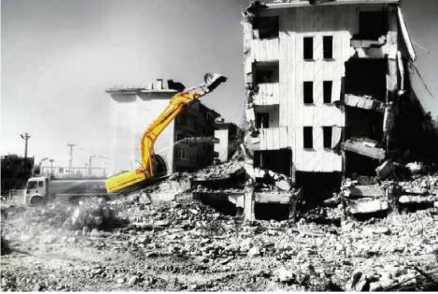
Dilek Sitesi, Ağır Hasarlı Bina Yıkım Anı (Kaynak: Faruk ÖNGEL, 2011, Van, Türkiye)
